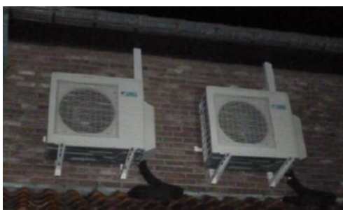
Buitenunits van splittoestellen, bron Dominic Van Clé.
