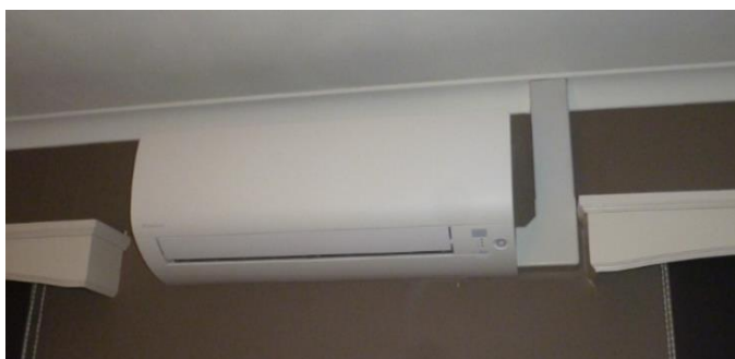
Binnenunit met afgeschermd, geïsoleerde leidingen bron: Dominic Van Clé.
