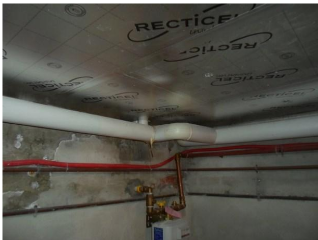
Geïsoleerde leidingen onder de vloerisolatie. (Foto: Isolteam)
