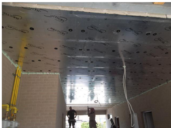
Isoleren van het plafond van een garage buiten het beschermd volume met vormvaste isolatieplaten. (Foto: Isolteam)
