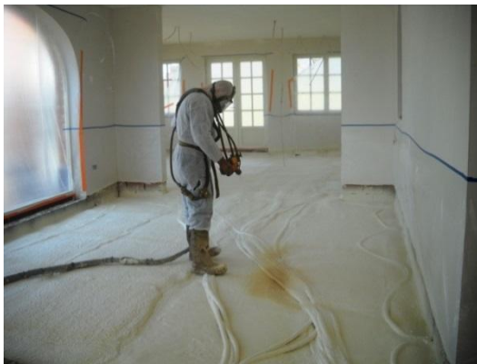
Spuiten van PUR schuim op de draagvloer, over de leidingen. (Foto: GT foam)
