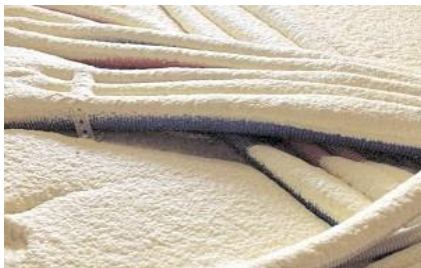
Holle ruimtes onder kruisende leidingen bij gespoten isolatie. (Foto: Isolatie Verhoeven)
