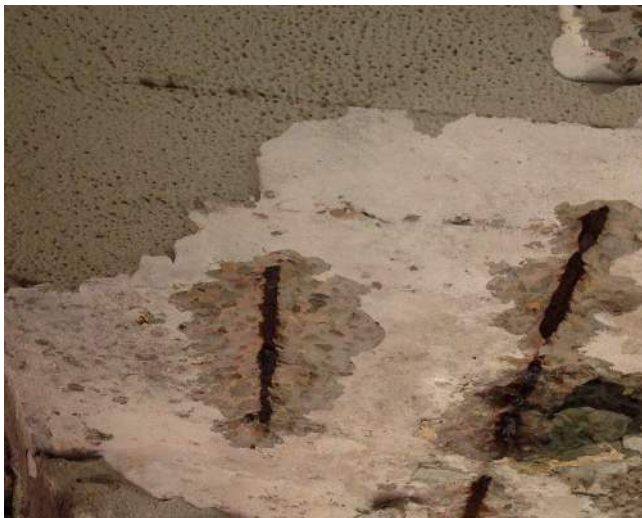
Kelderplafond met betonrot. (Foto: Group Rodinia)
