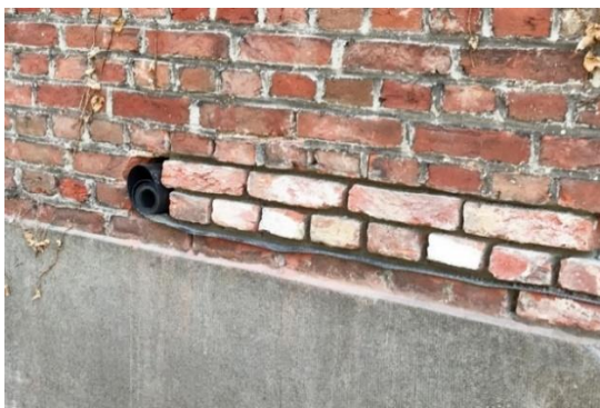
Onderkappen van een muur en de plaatsing van een waterkering om opstijgend vocht tegen te gaan. (Foto: murenvochtig.be)
