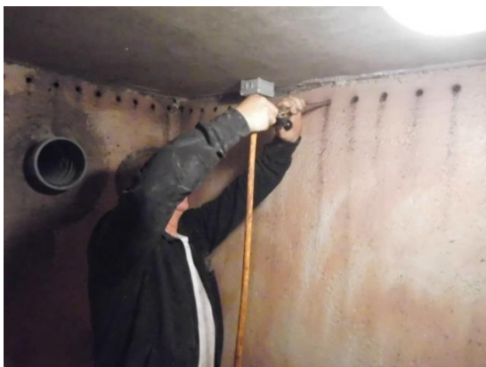
Injecteren ter hoogte van de bovenkant van een kelder muur, net onder de vloerconstructie. (Foto: meesterklusser.be)
