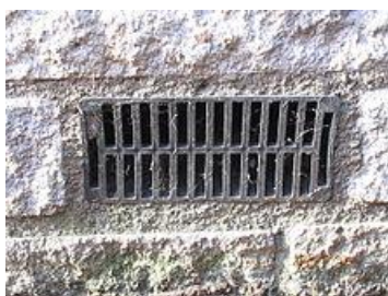
Verluchtingsrooster in spouwmuur, foto Wikipedia
