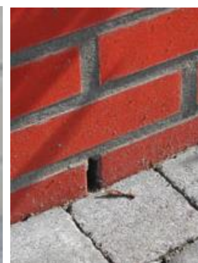
Te hoog geplaatste buitenverharding verhindert waterafvoer
