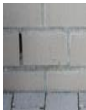
Stootvoegen niet open tot op de waterkering
