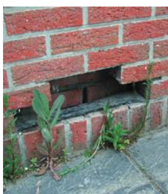
Verkeerde plaatsing van de waterkering: niet omhoog geplooid
