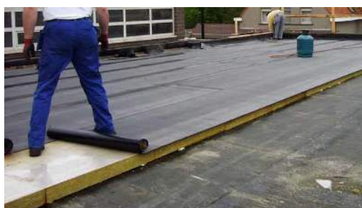
Warm plat dak met PU-isolatie (boven) en minerale wol, foto boven Deryckere-Accoe, onder arch. L. Groosman
