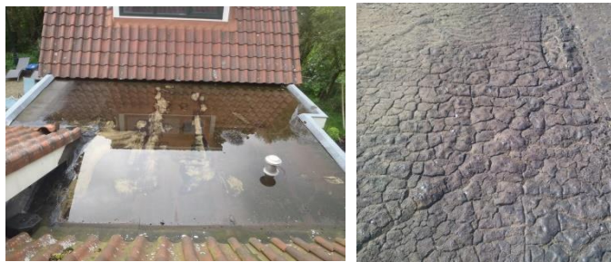
Plasvorming op een plat dak, verweerde dakafdichting
