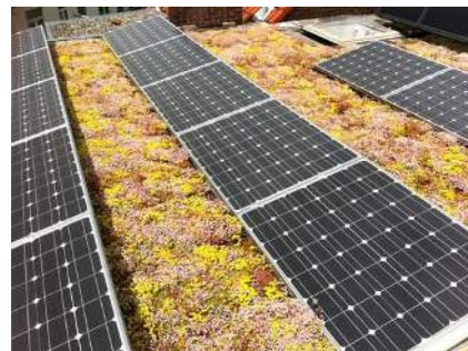
Een groendak verbetert de prestaties van fotovoltaïsche panelen, foto woningchecklist.nl
