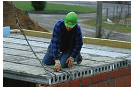
Massieve vloer met welfsels, open naar de spouwmuur (Foto: Livios)
