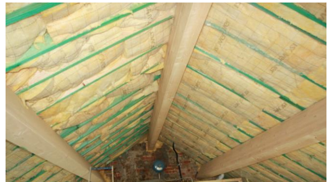
Onzorgvuldige (links) en zorgvuldige (rechts) plaatsing van isolatiematten. (foto: Paul Van den Bossche)
