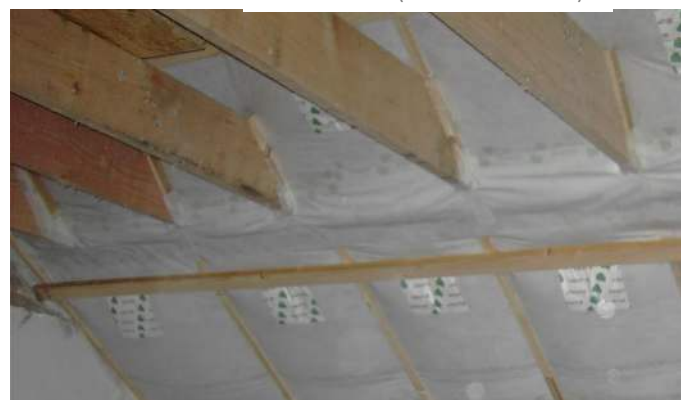
Spantendak: doorboringen van het luchtscherm ter hoogte van de trekbeamben (Foto: E-advies)
