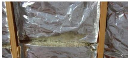
Verkeerde plaatsing van flensdekens (foto: Rockwool)
