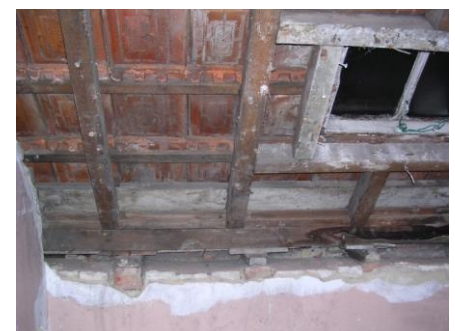
Houtwerk in slechte staat (Foto: E. Willaert)
