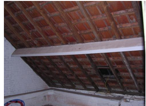
Hellend dak zonder onderdak (Foto: E. Willaert)
