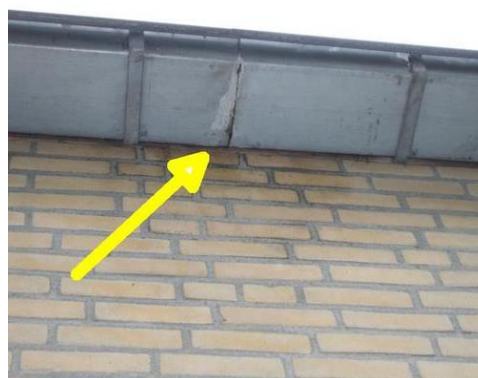
Een lekkende goot kan vochtproblemen in de muren veroorzaken, foto Dakdek-Gigant
