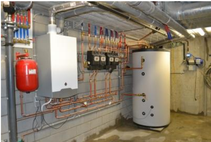
Vermijd om technische installaties buiten het beschermd volume te plaatsen (foto: Innotech)
