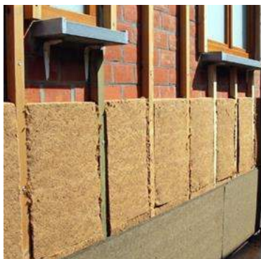
Niet-homogene isolatielaag: de muurisolatie is onderbroken door een houten structuur (Foto: Dialoog vzw)
