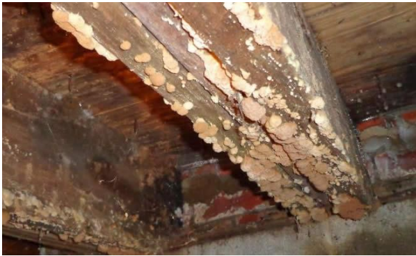
Zwamvorming op houten balken (Afbeelding: vochtbestrijding-experts.nl)
