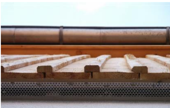
Insectengaas aan de onderzijde van gevelbeplanking (afbeelding: VIBE)
