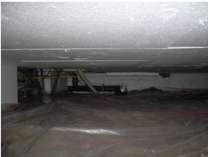
Kruipkelder met een bodemfolie en thermische isolatie tegen de onderkant van de bovenliggende vloer. (Foto: Tweakers)
