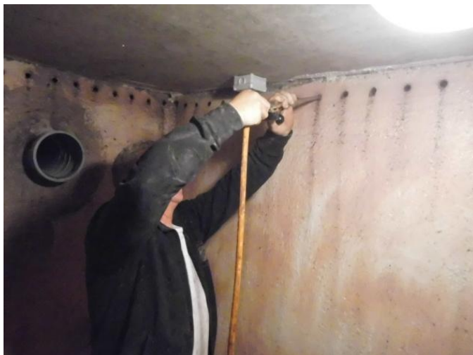
Aanbrengen van een horizontale waterkerende laag bovenaan een kelderwand door injectie. (Foto: meesterklusser.be)
